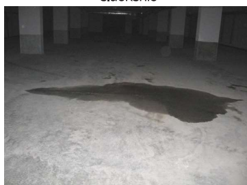
Betoninių grindų įtrūkimas, pro kurį skverbiasi požeminis vanduo
